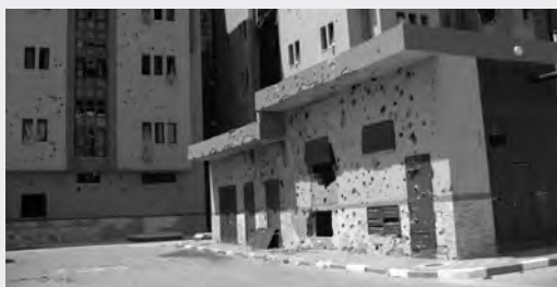
Ein bereits völlig fertiggestellter Neubau des Spital wurde im Zuge des jüngsten Krieges schwer beschädigt
